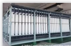
Tratamento de Efluentes: 315,000m³/d
